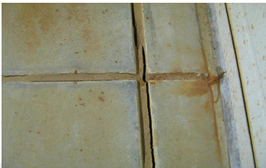
Foto: Beschadigde kitvoeg.
